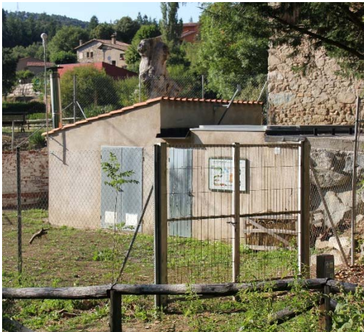
Dipòsit de subministrament de gas
